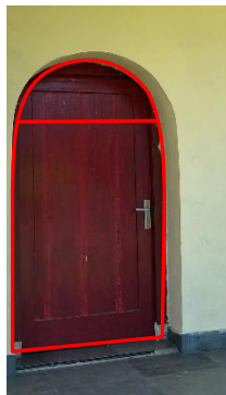
Gambar 7 Lengkungan dinding pintu
